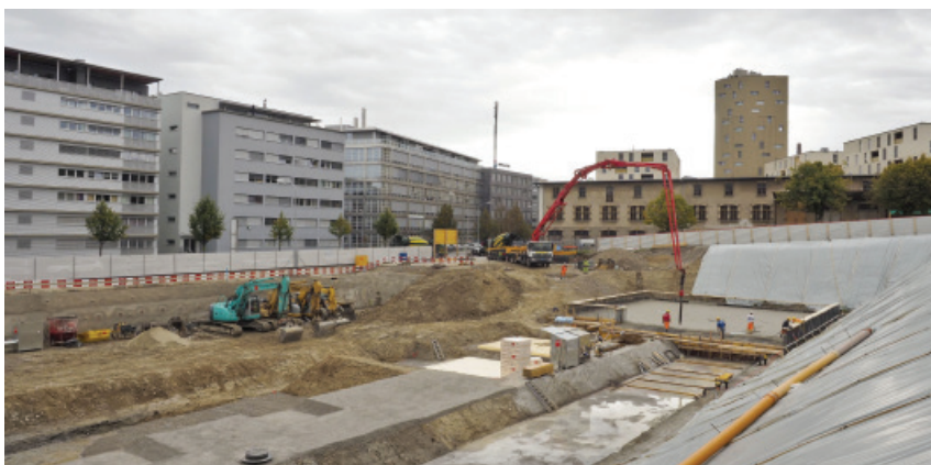
Le chantier du bâtiment Mozaïk, à la route des Arsenaux, en septembre 2015
